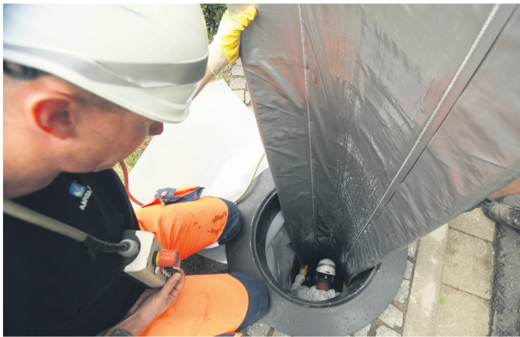
David Ebisch (links) kontrolliert das Abfahren des Inliners in den Kanal. Dort kontrolliert Albrecht Dietze die richtige Lage. Fotos: Katja Peters
