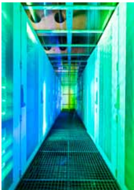
Kaltgang des neuen Serverraums
