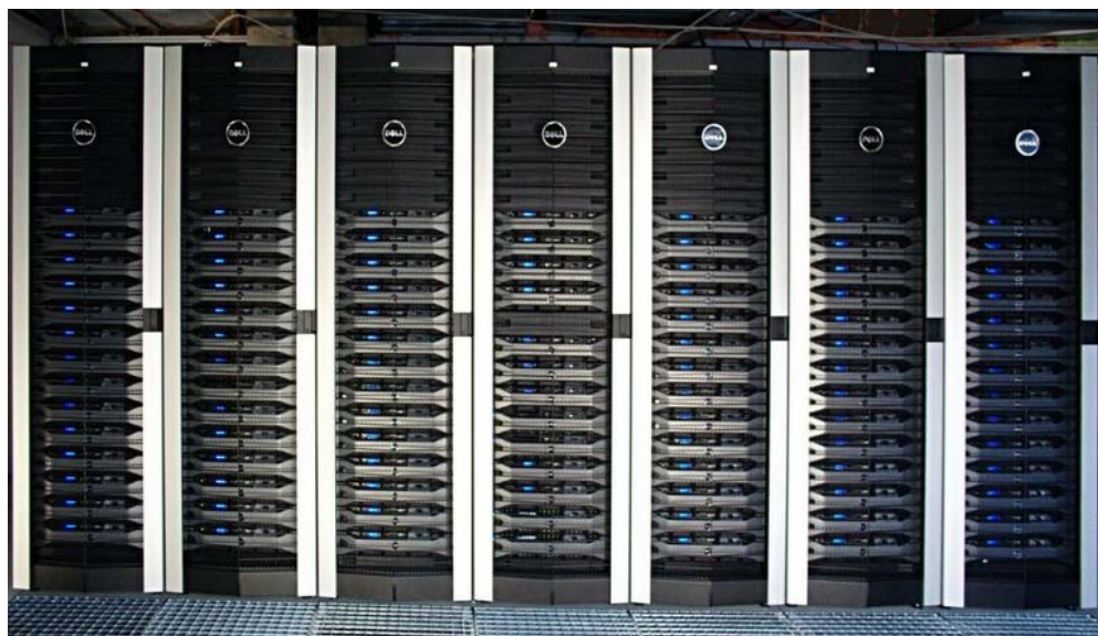
Vorderansicht der sieben Racks, die den HPC-Cluster MaRC2 beherbergen
