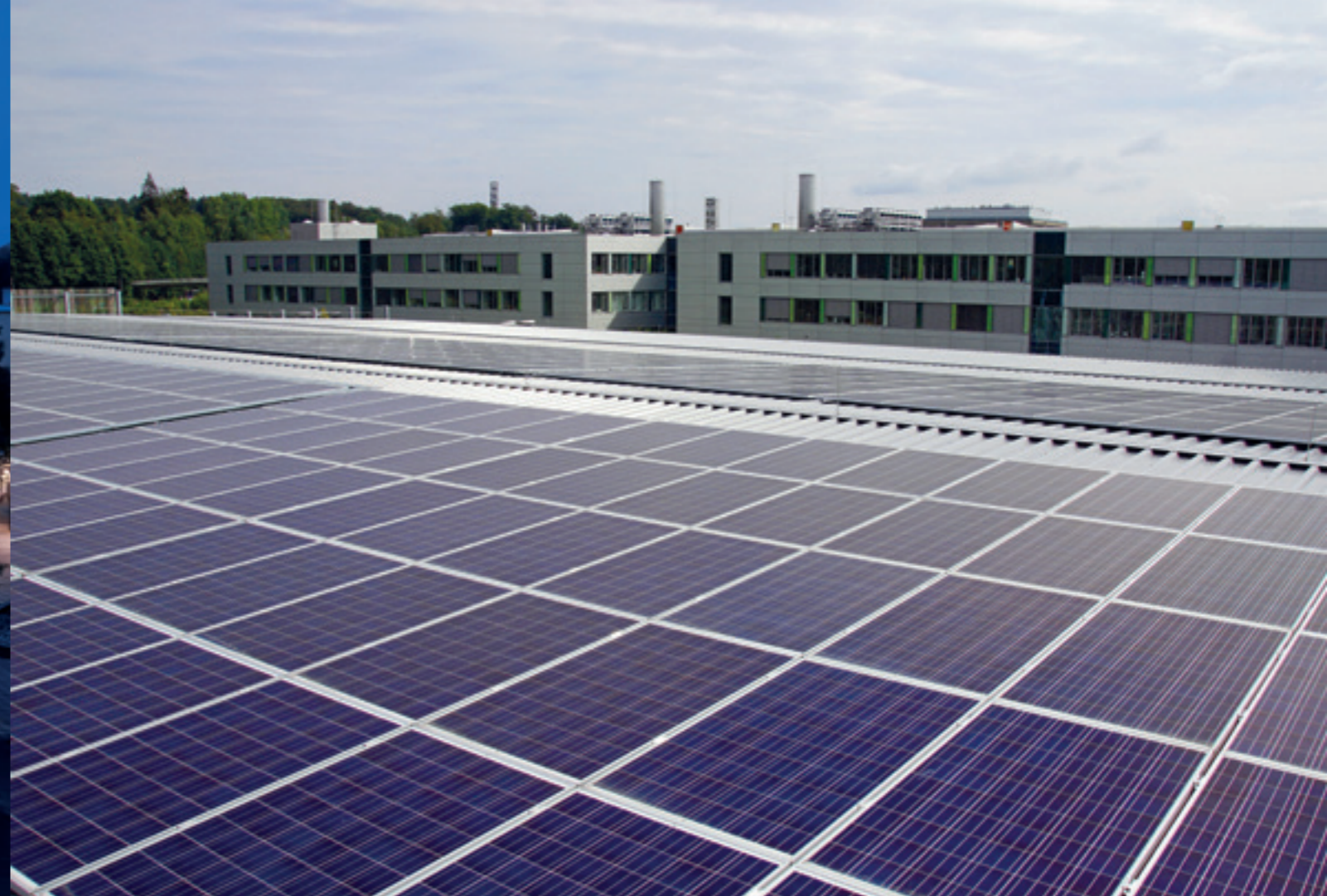
▲ Solarstromanlage auf dem Campus Lahnberge
