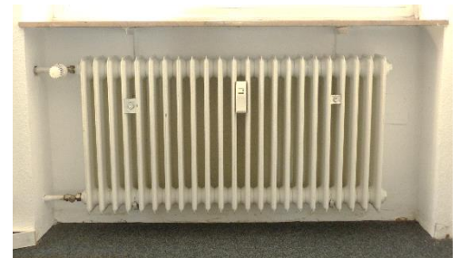
Abbildung 1: Die Heizkörpernische schon ohne Fußleiste.
